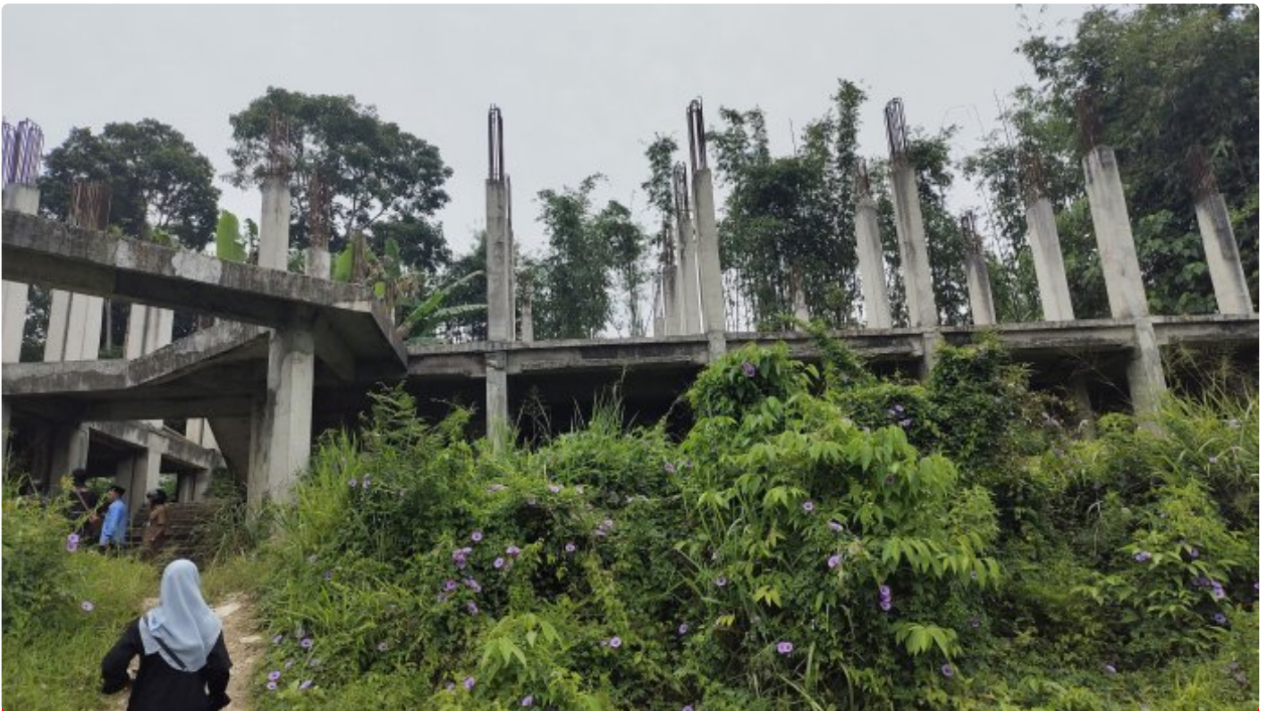
Pembangunan SDN 08 yang terbengkalai, Wako Perintahkan Kepala Dinas Pendidikan turun ke lapangan
