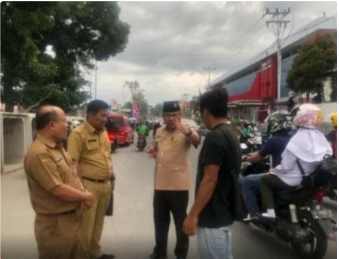
Sekda kota Bukittinggi Martias Wanto bersama jajaran mengecek pekerjaan drainase yang masih berjalan
